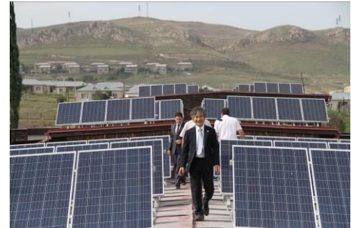
屋上に設置された太陽光パネル
