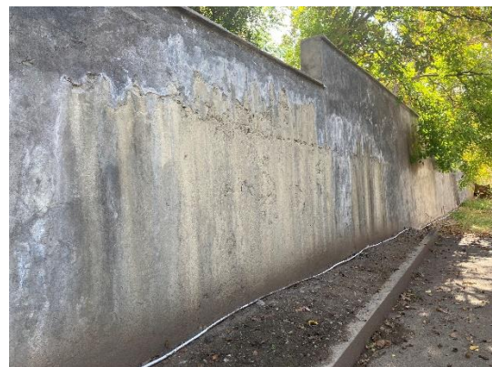
排水溝からの浸水によって損傷が進んでいる 幼稚園の外壁
