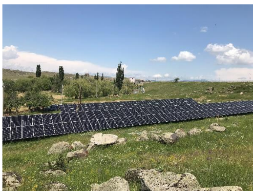
建設した太陽光発電所
