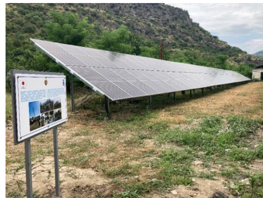
設置された太陽光発電設備
