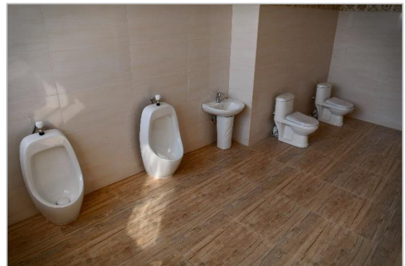
本事業で整備されたトイレ
